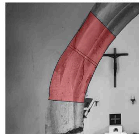
Figure 95 – Vue du 2 claveaux défaillants à remplacer à neuf
